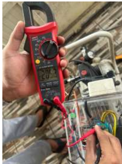
Gambar 8. Pengujian Tegangan Kompresor
