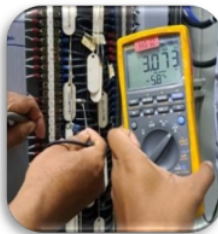
Gambar 11. Pengukuran Arus I/O Module dan Pressure Switch
