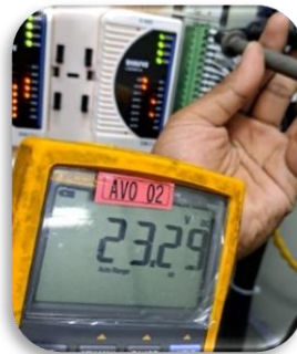
Gambar 10. Pengukuran Tegangan I/O Module
