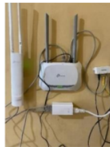
Gambar 9. Pemasangan Router TP-Link EAP 110
