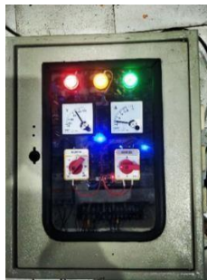
Gambar 3.3 Pengujian Tegangan R+T dan Ampere T
