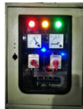
Gambar 7 Pembacaan nilai Tegangan R+S di Panel
