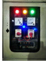
Gambar 8 Pembacaan nilai Tegangan S+T di Panel
