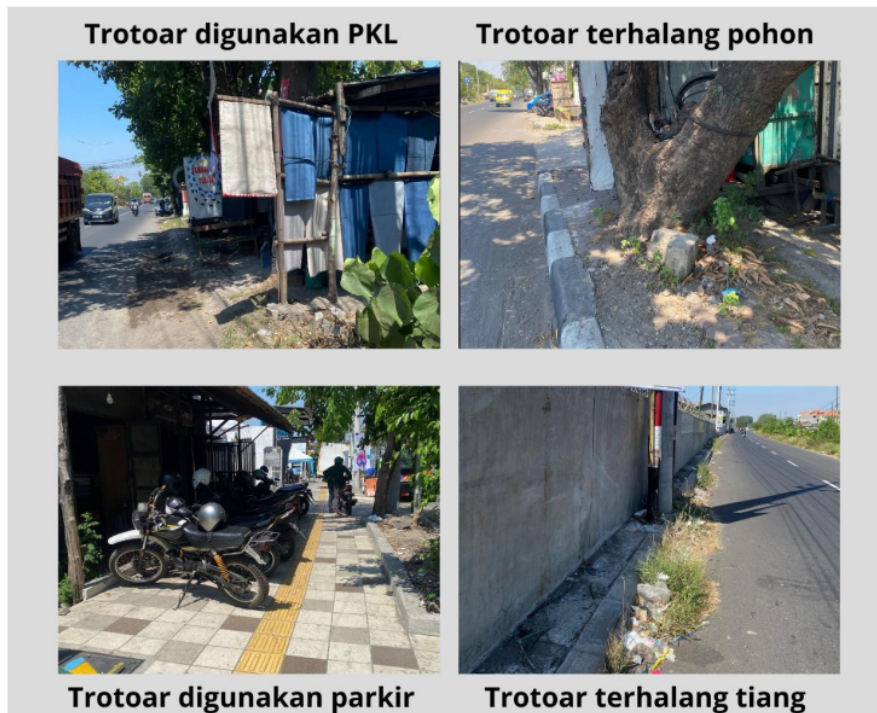
Gambar 2. Kondisi Trotoar di Sidoarjo
