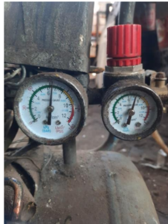
Gambar 3. Hasil uji tekanan kompresor konvensional
