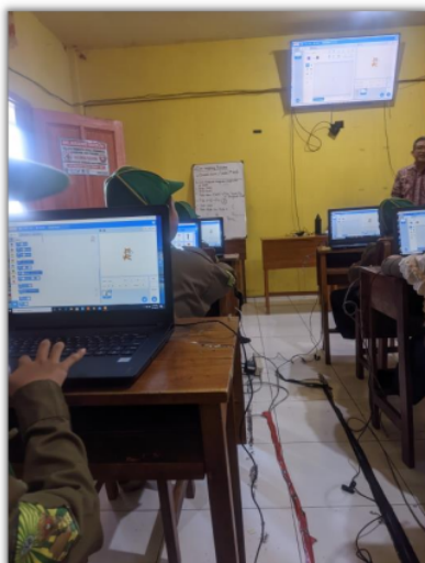
Gambar 3.3 Kondisi kabel di kelas belajar coding
