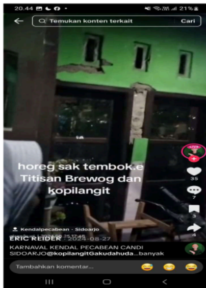
Gambar 3. Dokumentasi kerusakan rumah warga akibat Karnaval soundsystem yang terjadi di Kota Sidoarjo.
